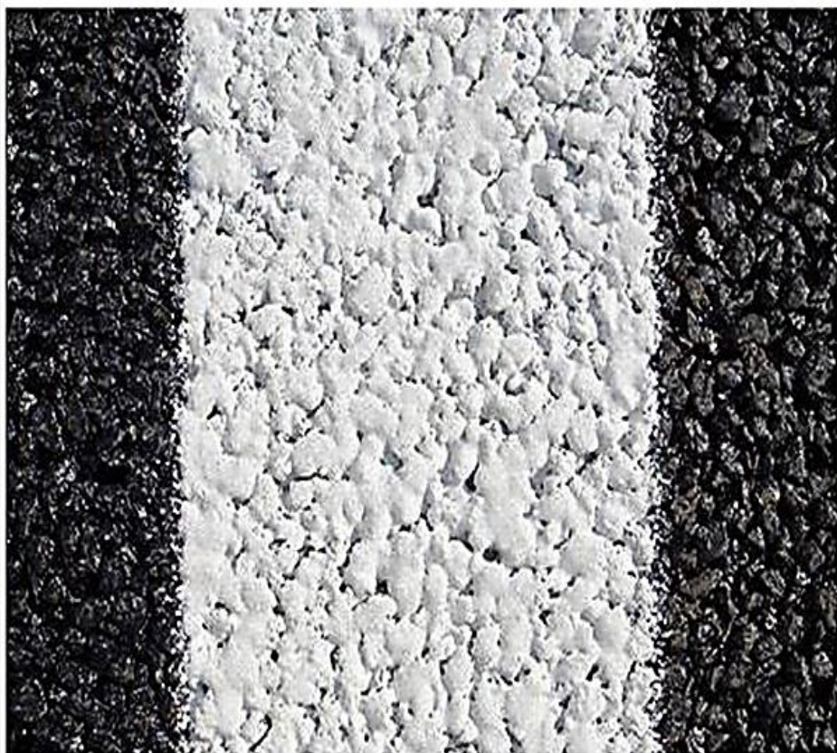
日本路面標線
